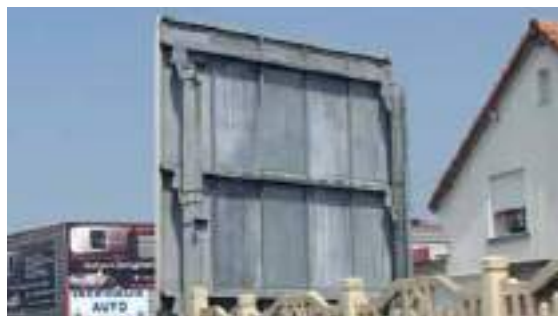
DÉFAUT D'HABILLAGE DU DOS
