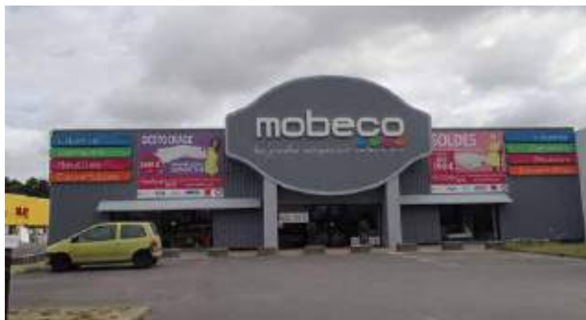
ENSEIGNE EN FAÇADE DÉPASSANT DU MUR
